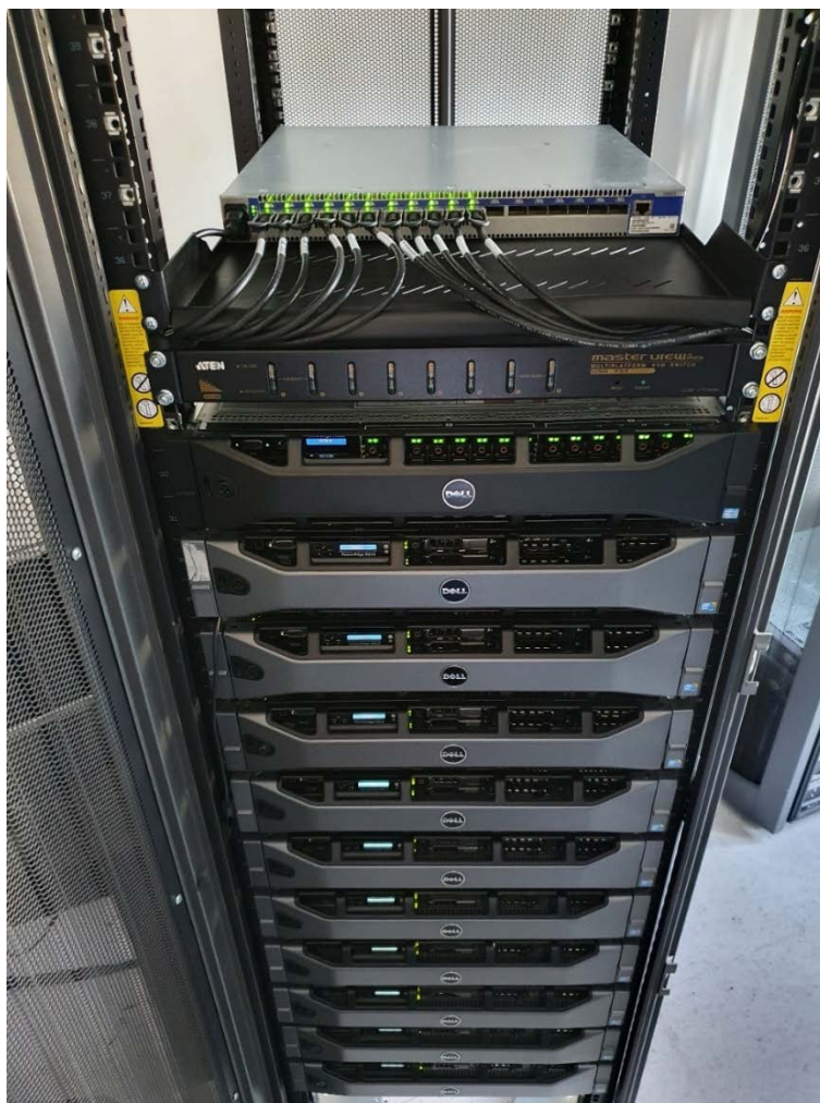
Clusterul din INCAS după Instalarea InfiniBand
