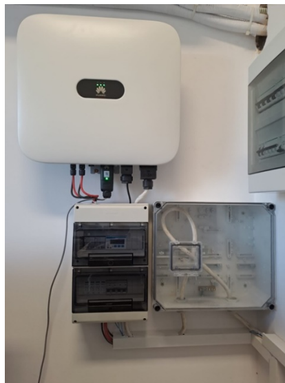
Invertorul Huawei, sistemul de monitorizare prin internet si carcasa unui contor de energie
